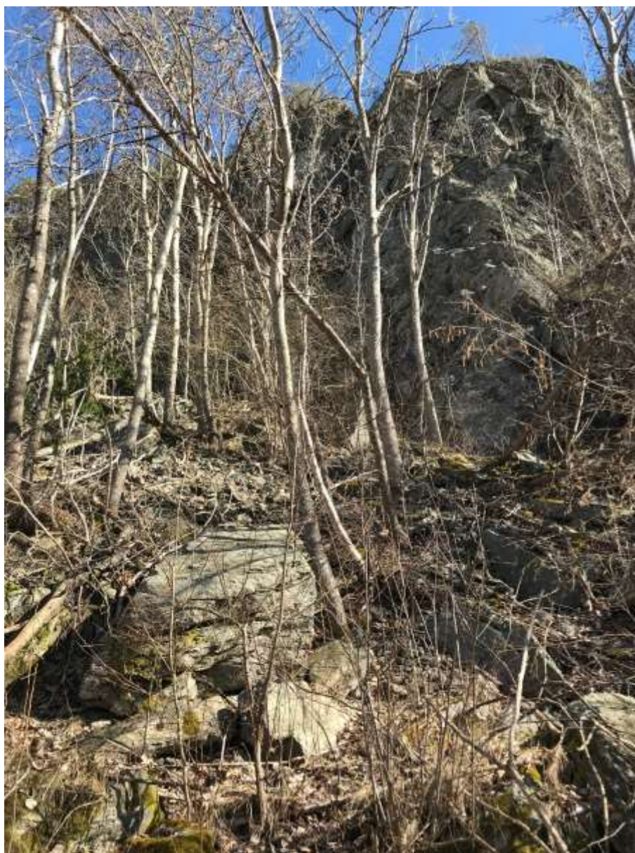
Figur 5. Ungefärligt läge för utsiktsplats, med öppna sprickor i bergsbranten och talusbrant i släntfot. Enstaka block har kantlängd 2-3 m.
