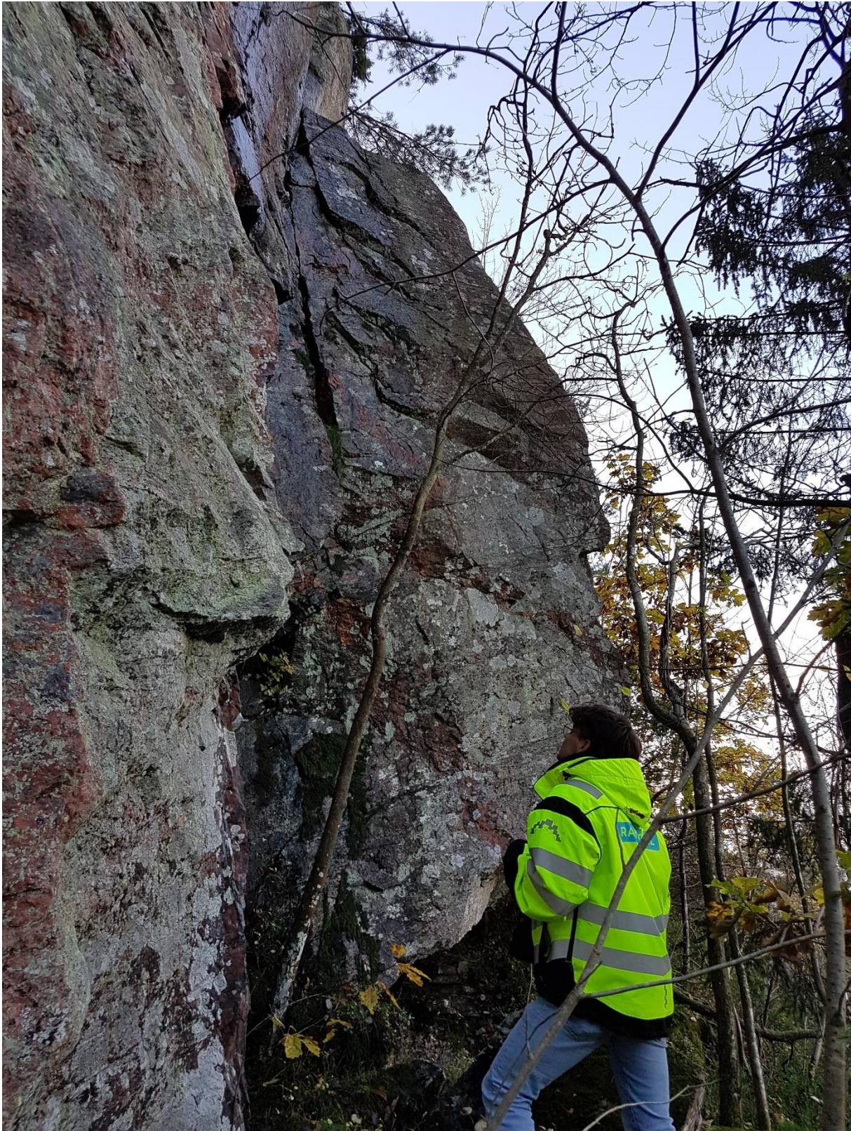
Figur 7. Stort potentiellt löst block som kräver stabiliserande bergteknisk åtgärd.
