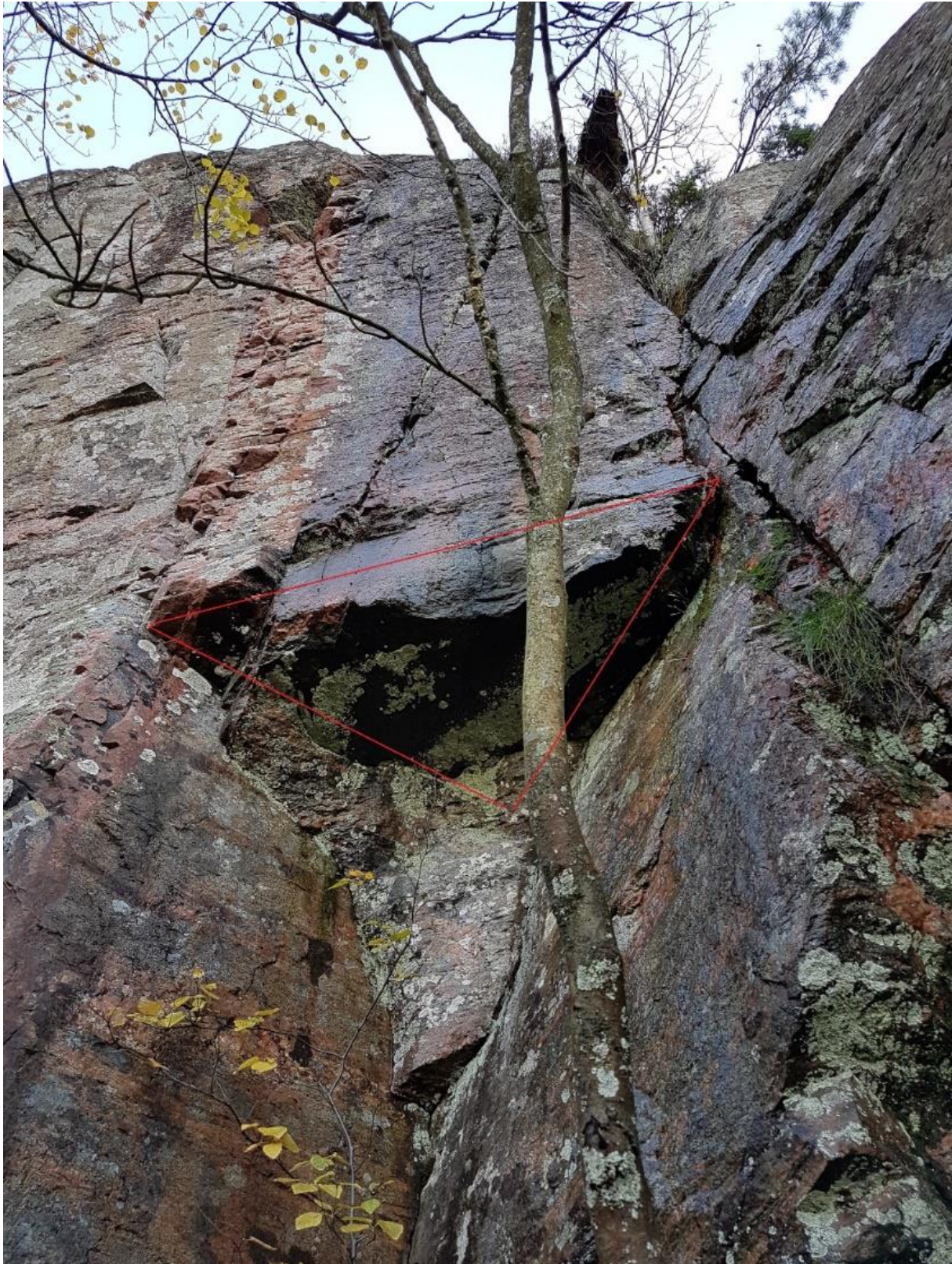
Figur 6. Kil om ca 3 m 3 med vattenförande sprickor som falla ut på grund av frostsprängning och erosion, se röd markering.
