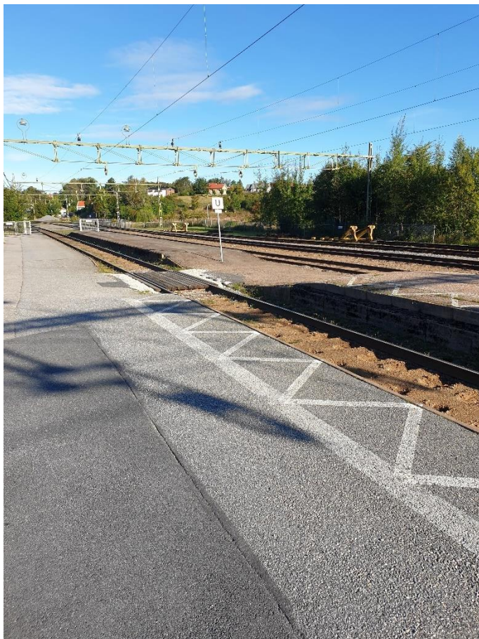
Figur 5 Bangård i Munkedal med sidoplattform för spår 1 i förgrunden. Plankorsning över spår 1 till mittplattform. Bilden är tagen söderut.
