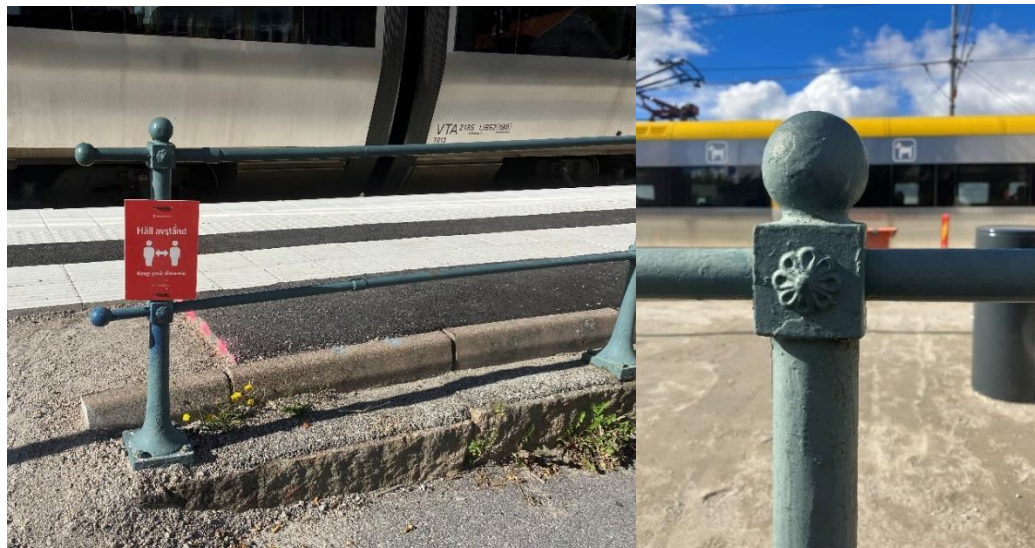
Figur 1. Staket på Strömstad station.
