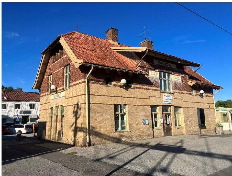
Figur 6 Stationshuset i Munkedal är privatägt och är i relativt fint skick med renoverade fönster och dörrar. Del av stationshuset har hyrts ut till Västtrafik för att kunna bruka vänthallen. Sedan en tid tillbaka är vänthallen inte öppen för allmänheten.
