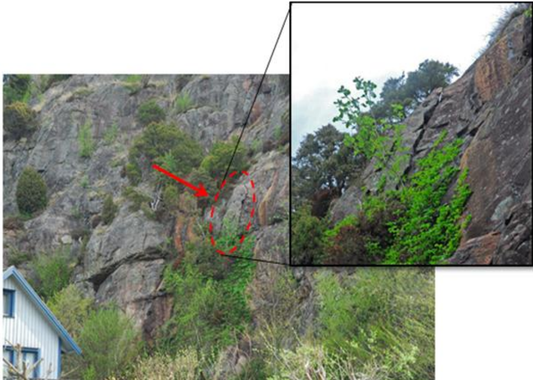
Figur 2 Bild över fastighet 3:2. Stor risk för blockfall med stor sannolikhet att huset blir skadat. Bilder är tagna bakom huset på ett höjd av 20-30 m, höjden nås från marknivå.
