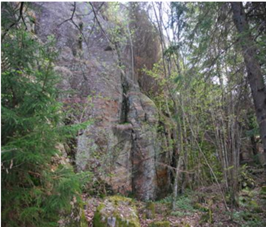
Bild 45. Högre upp mot fastighet 3:26. Stora lösa block som riskerar att falla ut.
