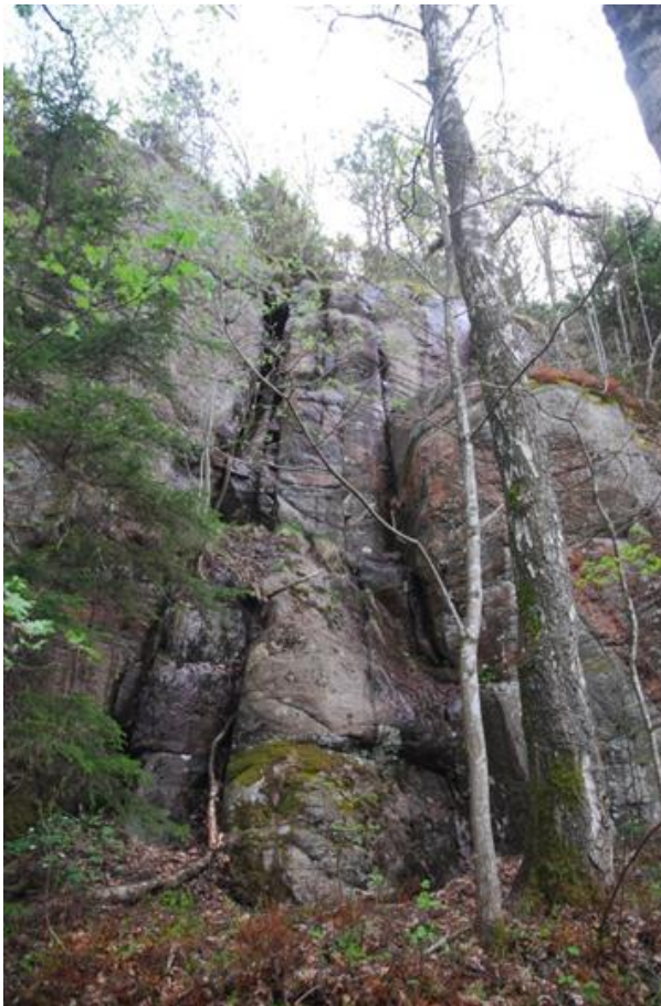
Bild 49. Högre upp mot fastighet 3:26. Naturlig blockighet, öppna sprickor, stor risk för avlossning av skivor eller block. Dock inga hus eller tomtor i direkt anslutning till slänt.
