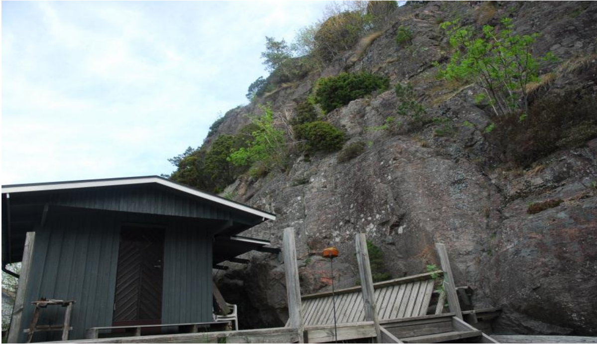
Bild 26. Lösgjort block som genom fortsatt rotsprängning riskerar att orsaka blocknedfall ovanför fastighet 3:14.
