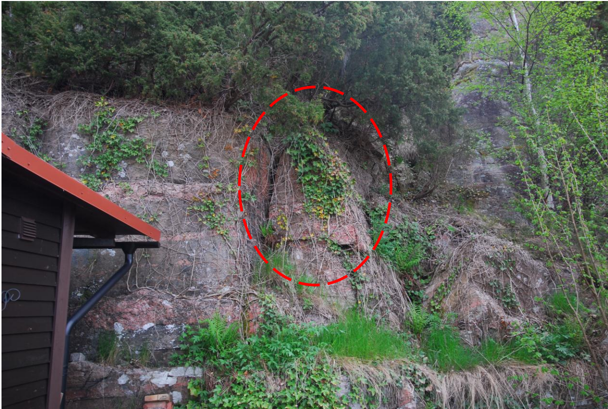
Bild 16. Lösgjort block om ca 1x1,5 meter. Fortsatt rotsprängning riskerar att orsaka blocknedfall.
