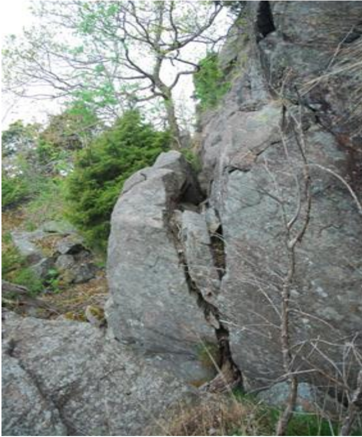
Bild 23. Blockansamling nedanför brant bergslänt ovanför fastighet 3:14. Blockansamlingen tyder på instabilt berg med tätare sprickbildning. Fortsatt risk för ras bedöms vara stor.
