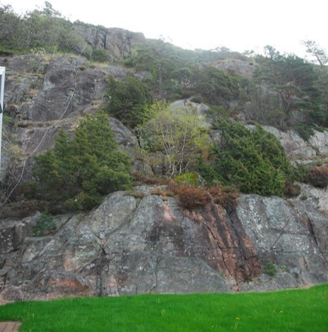
Bild 8. Löst block 5 meter upp på bergslänten. Blocket ligger instabilt på inåtlutande häll med vegetation som genom rotsprängning kan försämra stabiliteten. Fastighet 3:3.
