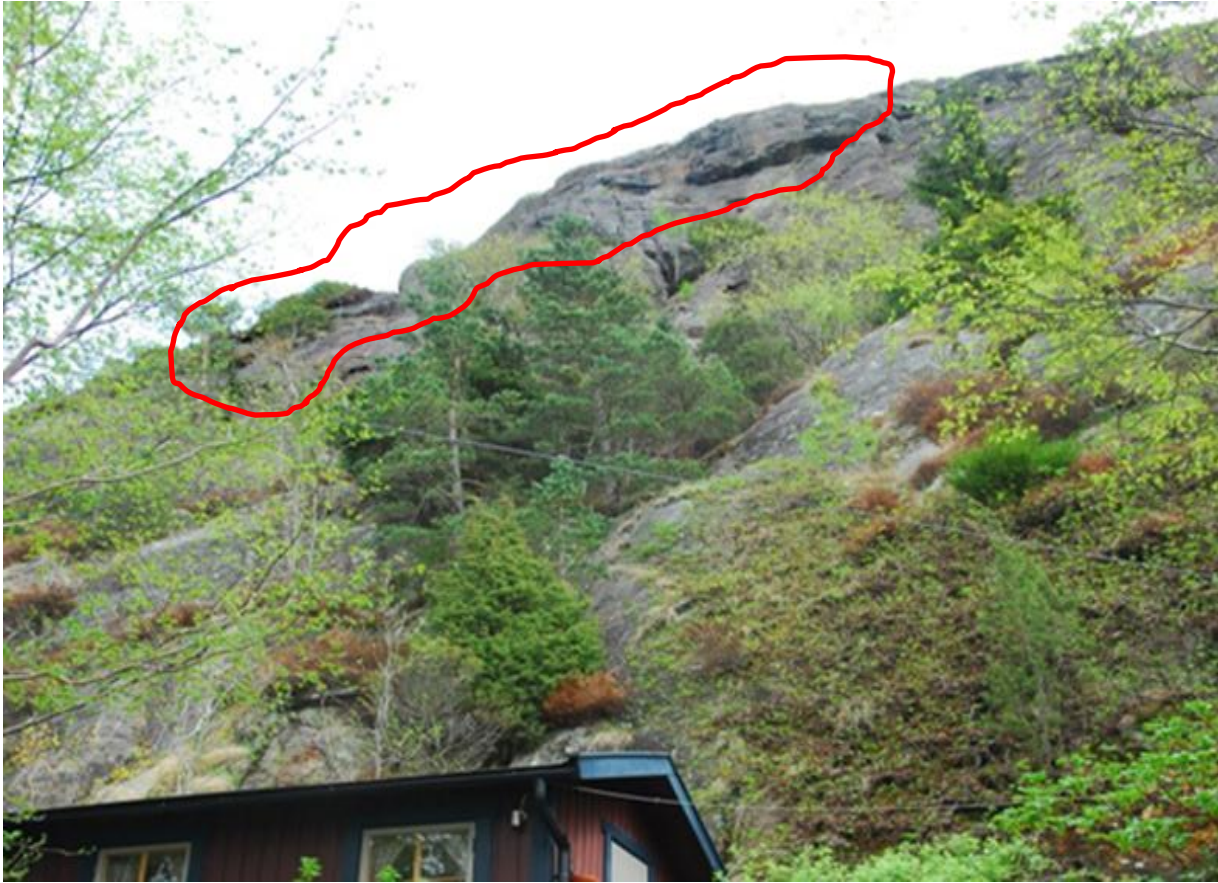
Bild 40_2. Fastighet 3:18. Viss förhöjd risk för nedfall, en mer detaljerad utredning rekommenderas.
