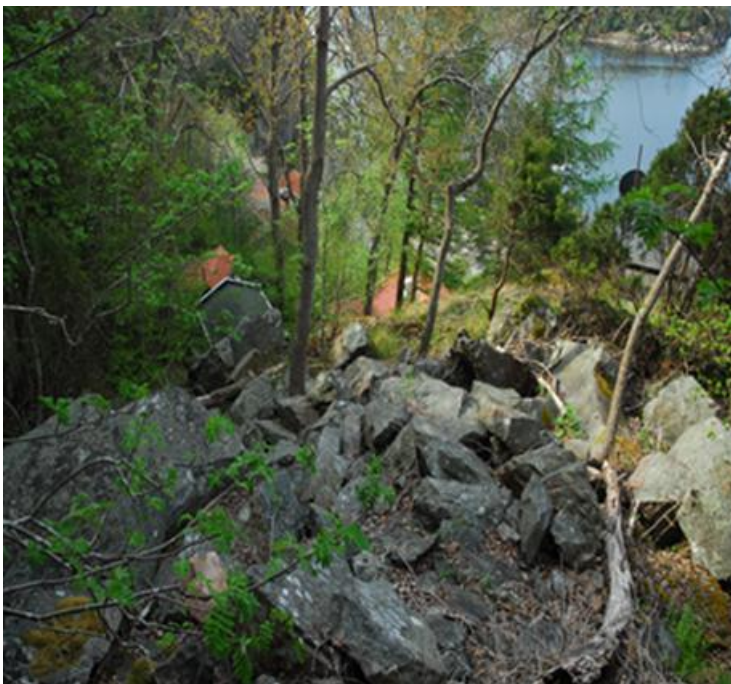
Bild 24. Blockansamling nedanför brant bergslänt ovanför fastighet 3:14. Blockansamlingen tyder på instabilt berg med tätare sprickbildning. Fortsatt risk för ras bedöms vara stor.
