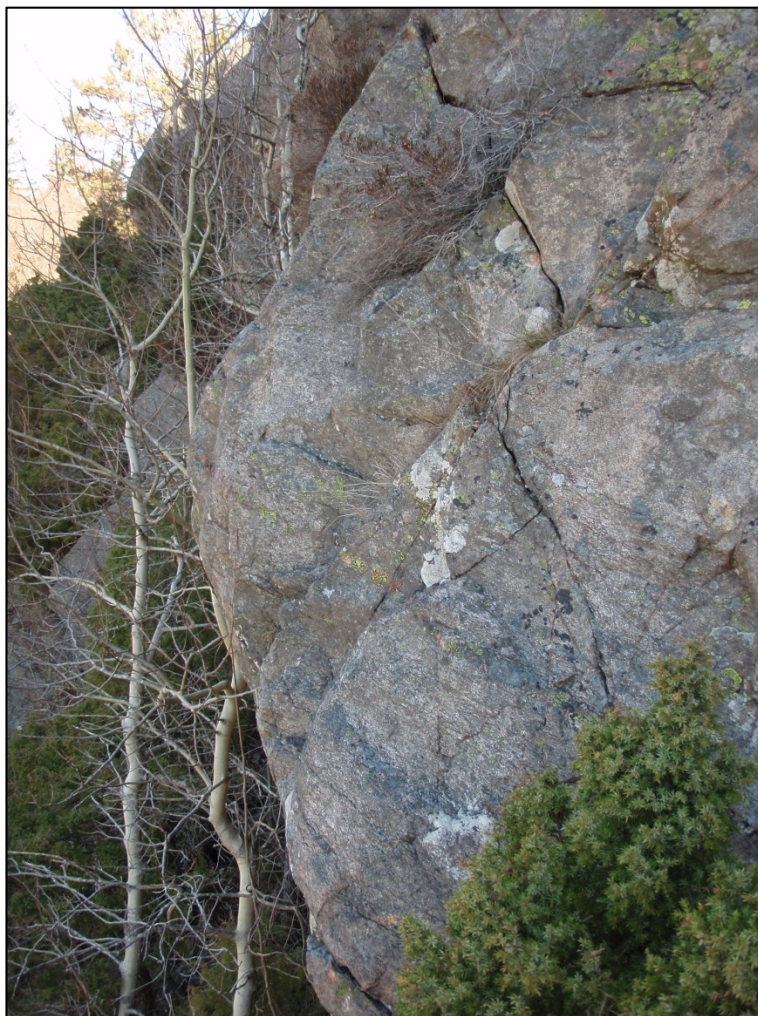
Foto 6. Fastighet 3:4, område för bultning - detalj
